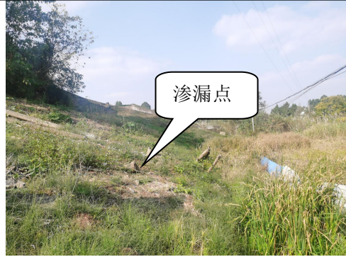
图 3-6 右坝左侧渗漏（汛期）
