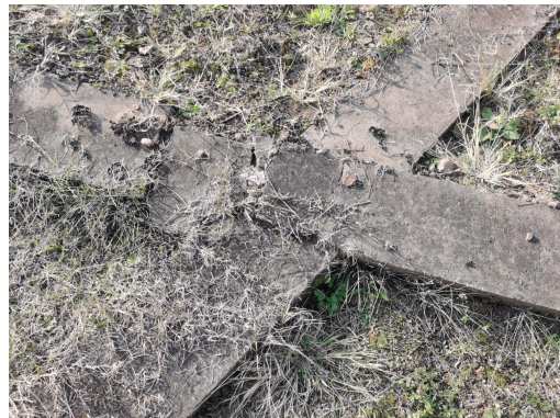
图 3-8 左坝下游二级坝坡框格梁破损
