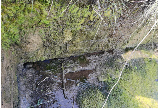
图 3-5 右坝右坝脚渗漏
