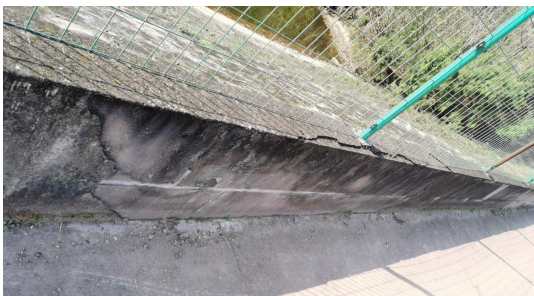
图 3-9 左坝下游二级坝坡框格梁破损
