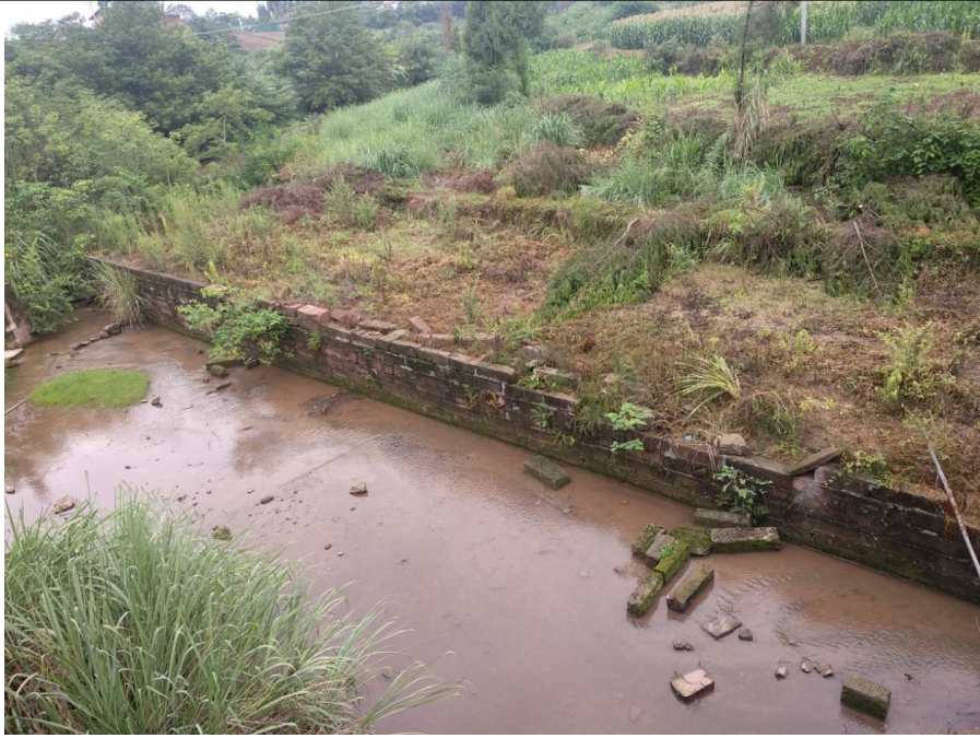
图 3-10 溢洪道消力池后防冲墙被冲毁（已临时恢复）
